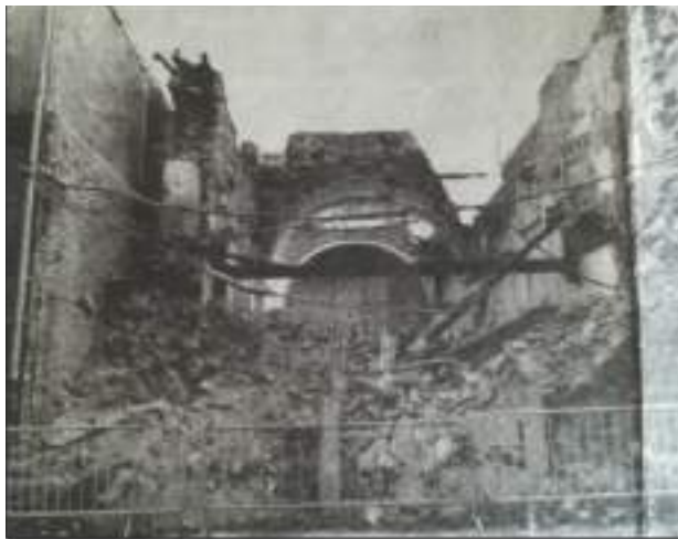
Derrumbe de la nave de la ermita de La Piedad.
