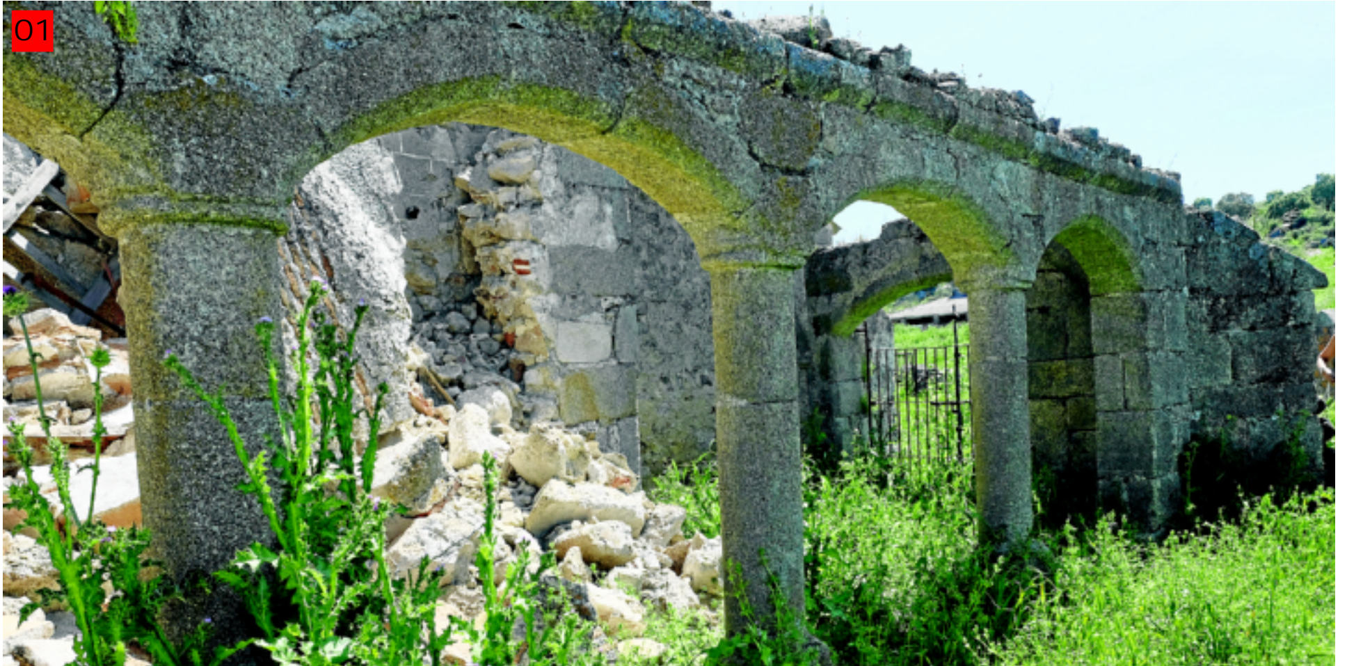
33 Pórtico de Nuestra Señora de la Esclarecida, templo de Zamarrillas que da acceso al resto de las edificaciones. Acaba de sufrir un desplome parcial.
